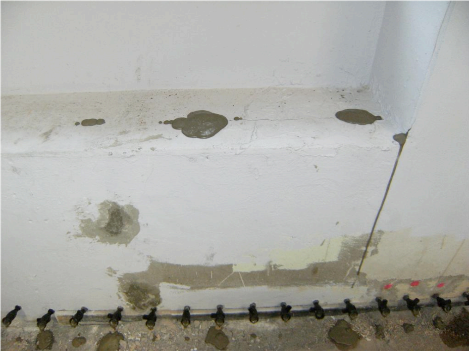
Foto 5: Austretende Bohrlochflüssigkeit: Das Mauerwerk ist gesättigt
