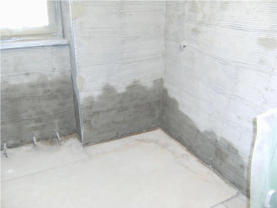
Auf dem Egalisiermörtel zeigt sich letzte Restfeuchte durch die Injektionsvorgänge
