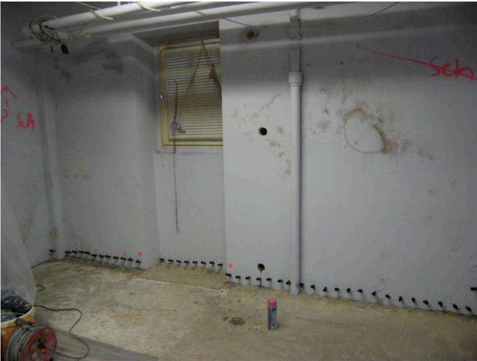
Foto 3: Aufsteigende Feuchtigkeit sorgte für raumhohe Salzausblühungen und Abplatzungen an den Kelleraußenwänden der Staatlichen Gewerbeschule
